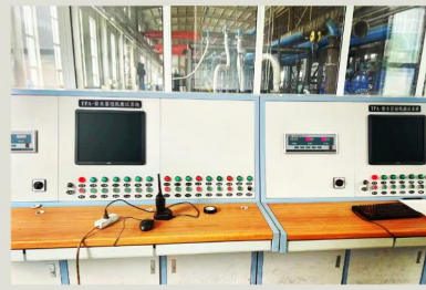
整泵测试 Комплексные испытания
